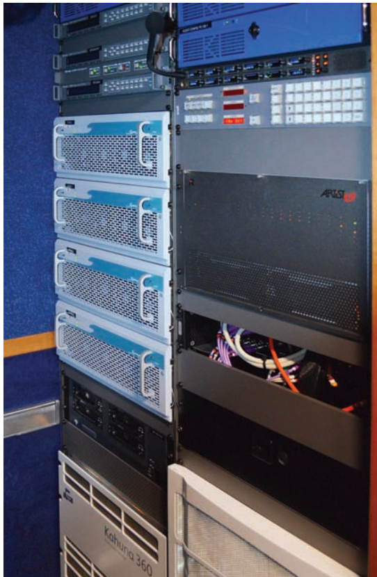
Системы Axon Synapse, установленные в одной из 10-камерных ПТС АНО «Спортивное вещание»
